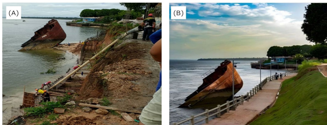
Figura 10 – A) Antes do muro de Arrimo; B) Depois do Muro de Arrimo no Cais para conter as erosões.
