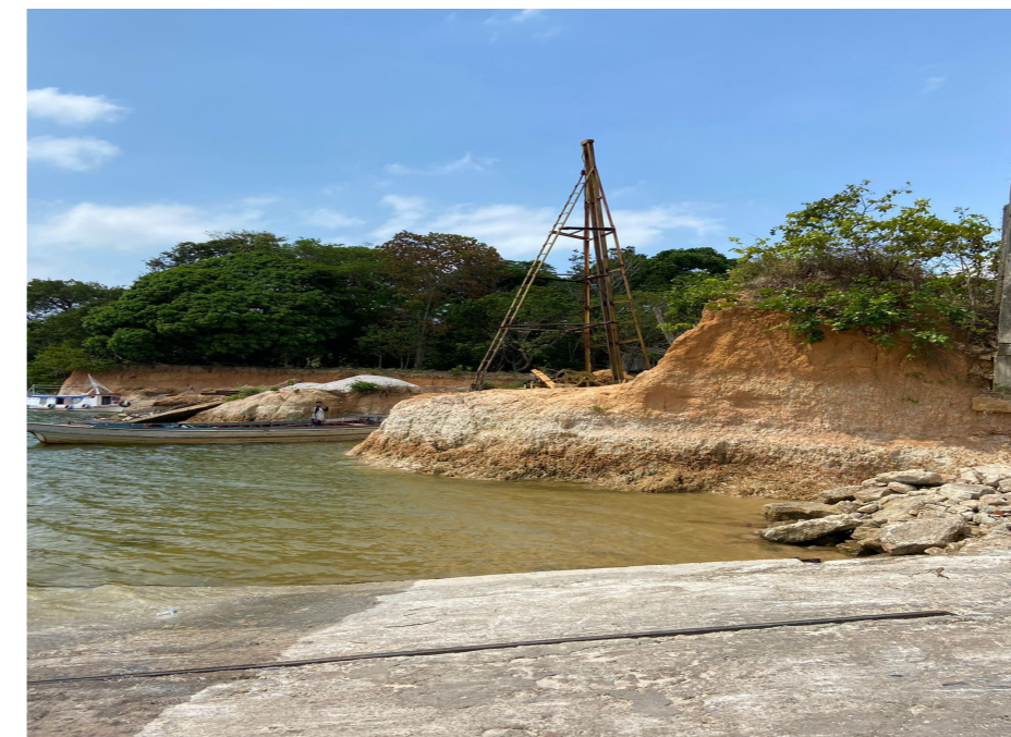
Figura 9 – Feição 4 situada no P4, talude comprometido.
